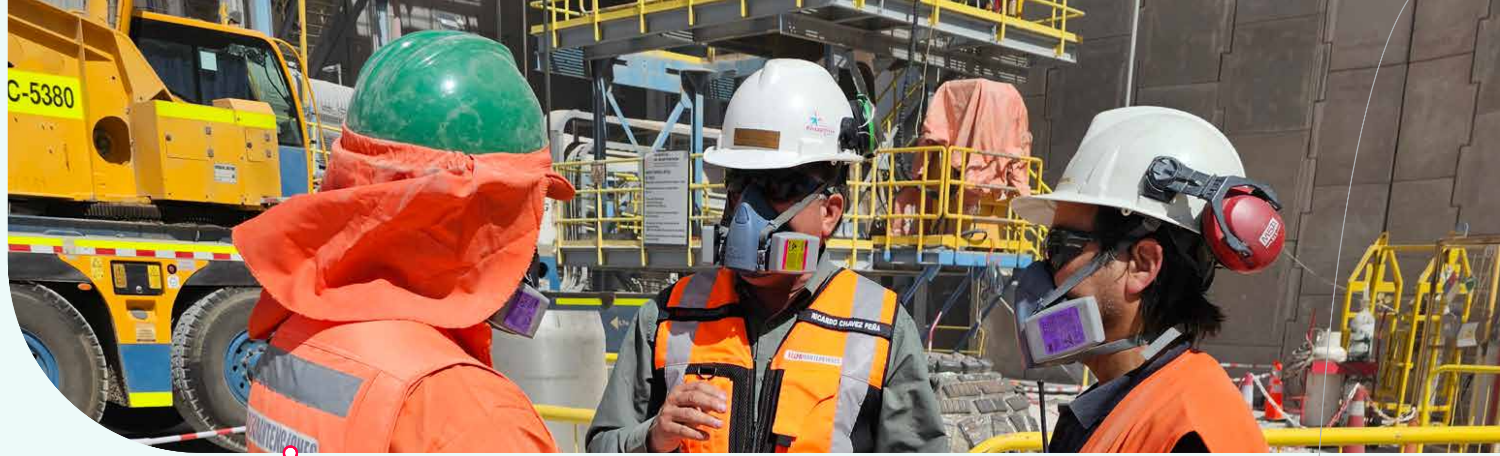
Codelco División Ministro Hales, Mantenimiento Chancado Primario, Calama, Región de Antofagasta, Chile.
