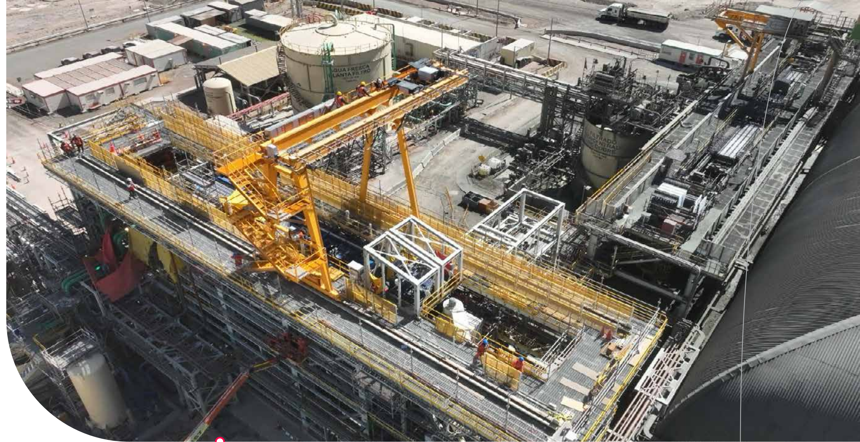
BHP - Spence, Contrato de Construcción Step 1 y 2 Spence Concentrator Upgrade (SCU), Sierra gorda, Región de Antofagasta, Chile.
