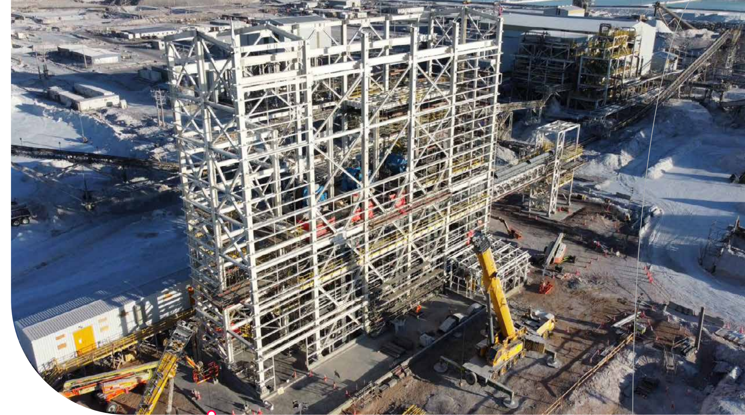
SQM Salar S.A., Montaje Electromecánico de la Planta Lixiviación y Filtrado, San Pedro de Atacama, Región de Antofagasta, Chile.
