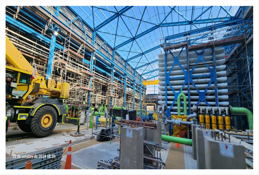
Planta Desaladora ADASA
